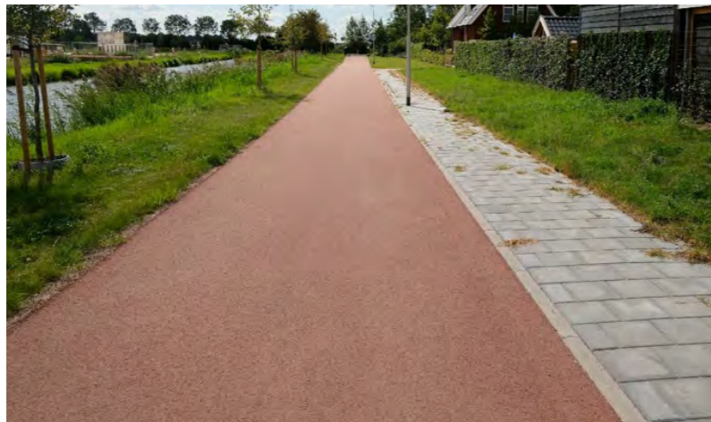
Een standaard fietspad met trottoir wordt in de basis niet gebruikt door auto's
